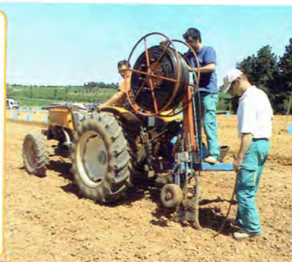
Le goutte-à-goutte enterré peut s'installer en utilisant une dérouleuse qui ouvre le sol, déroule et rebouche la tranchée.
