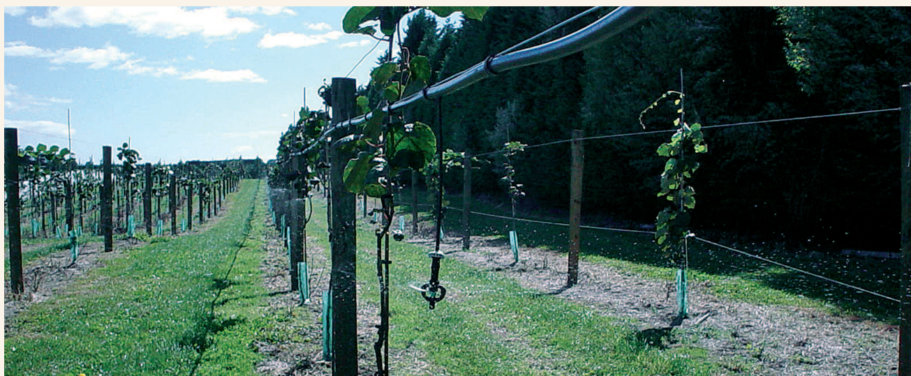
Un montage pendulaire sur rampe est envisageable essentiellement avec les micro-jets et micro-asperseurs.
